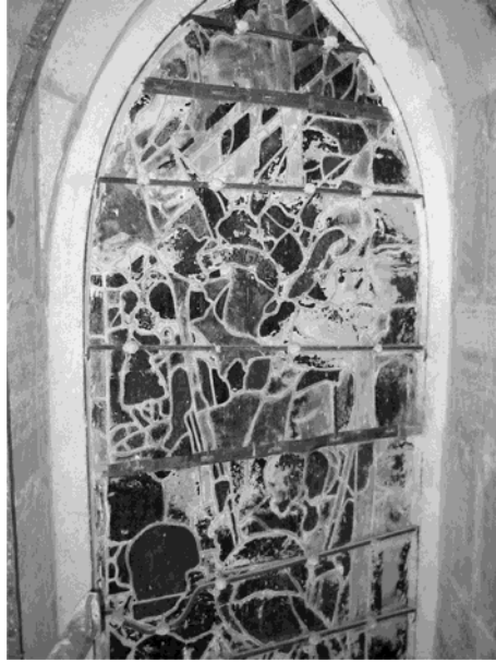
Figura 7. Imagen de la cara exterior de una vidriera con restos de deyecciones de palomas (palomina).
