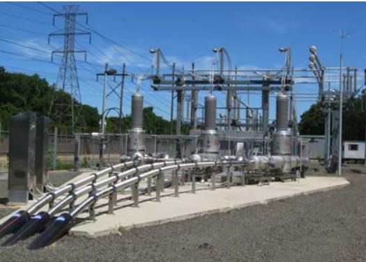
Conexiones de un cable superconductor instalado en Long Island. Cortesía de American Superconductors
