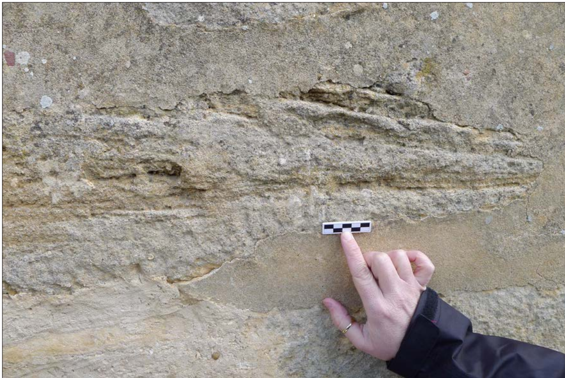
Fig. 13. San Miguel de Escalada, alzado norte. Mampuesto de conglomerado cementado, obsérvese la laminación y estratificación cruzada propia de estos niveles
