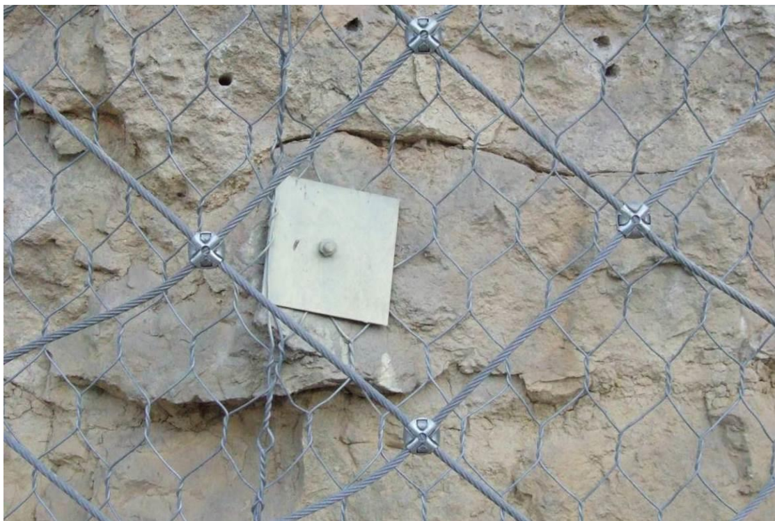
Figura 105. Diferentes tipos de fijaciones de los taludes instalados en la Cuesta de los Hoyos, como bulonado con placas metálicas, y mallas de triple torsión de diferentes formas y pasos.
