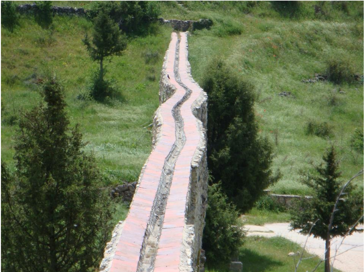
Figura 9. Vista cenital-lateral del tramo del acueducto de Pedraza (acueducto del Caño) en su parte elevada en arquería, donde se aprecia una deformación sinusoidal en el trazado en planta, que ha sido atribuida al efecto del terremoto de Lisboa de 1755. Fuente: Díez-Herrero (2019).
