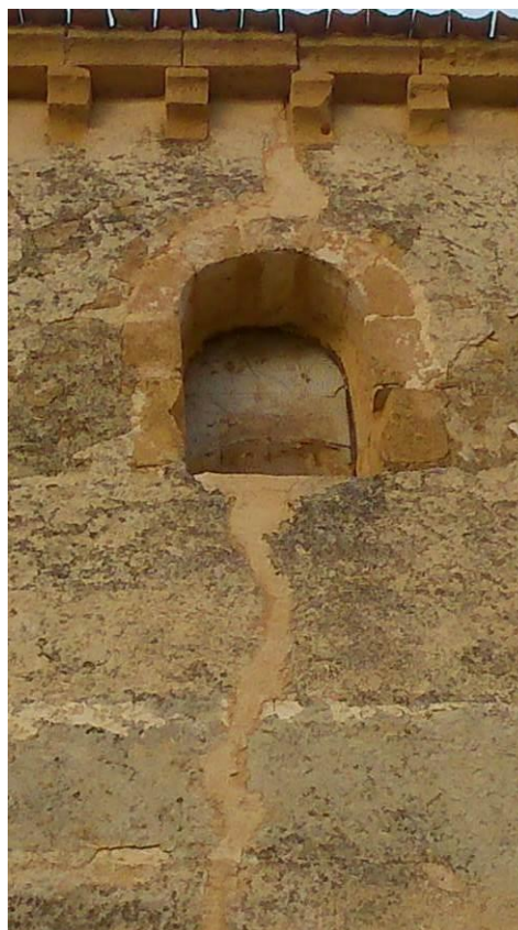
Figura 87. Fachada suroccidental de la iglesia de la Veracruz, con la reparación de grietas penetrativas y la clave de la ventana desprendida.
