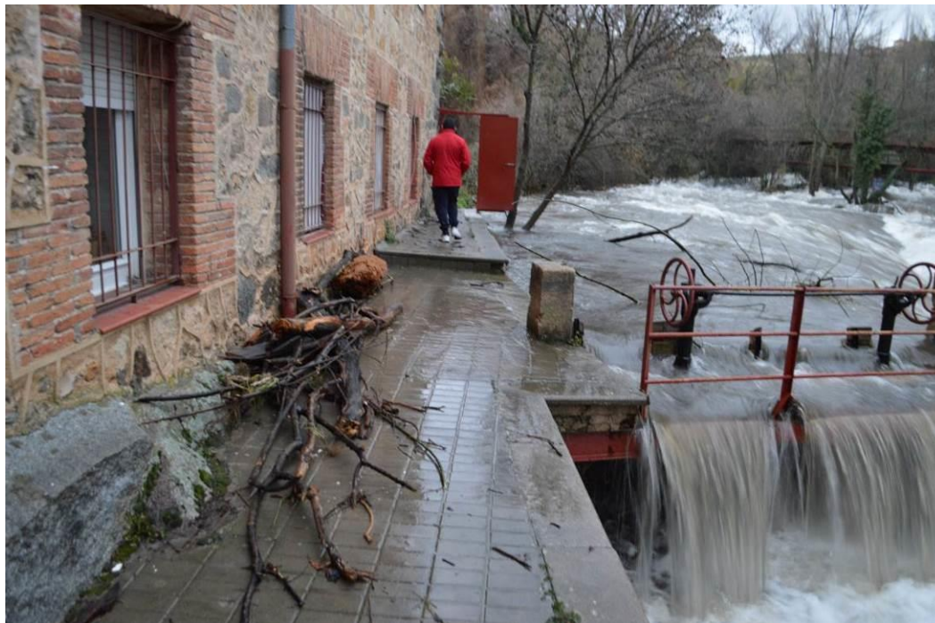
Figura 77. Inundación de la acera y depósito de restos vegetales en la trasera de las viviendas de la calle Anselmo Carretero, en la margen derecha del río Eresma a su paso por el barrio de San Lorenzo, en la tarde del día 11 de diciembre de 2020.
