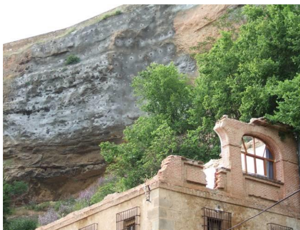
Figura 99. Detalle del bulonado y gunitado elegido como solución técnica para la fijación de la placa de roca contigua a la zona desprendida.
