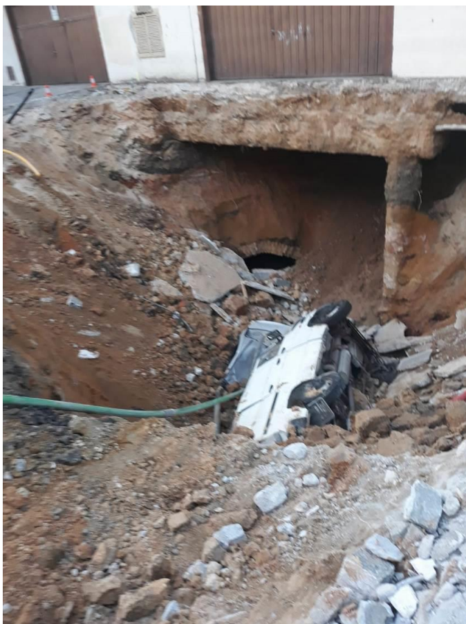
Figura 115. Socavón en la plaza Aurelio Hernández del barrio de San Millán, formado por el colapso de la bóveda de la conducción subterránea del arroyo Clamores, tras la avenida súbita del 27 de agosto de 2019.
