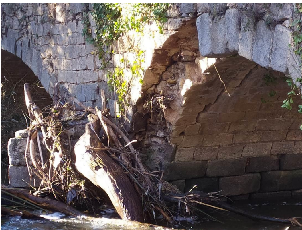
Figura 80. Daños producidos por la avenida y la carga sólida leñosa transportada en el tajamar y arco del puente de acceso al antiguo monasterio de Los Huertos, en la Alameda del Parral.
