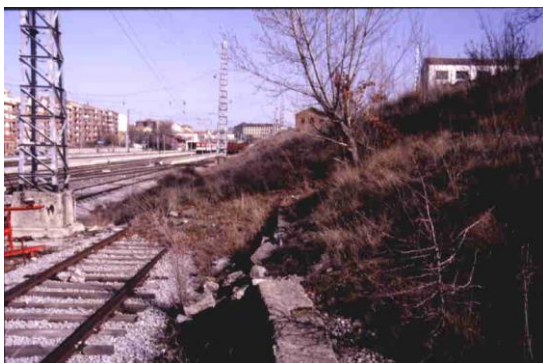
Figura 121. Pie y frente del deslizamiento rotacional invadiendo la vía de acceso al almacén de máquinas, y combando y rompiendo el murete de contención. Fotografía de mediados de la década de 1980.
