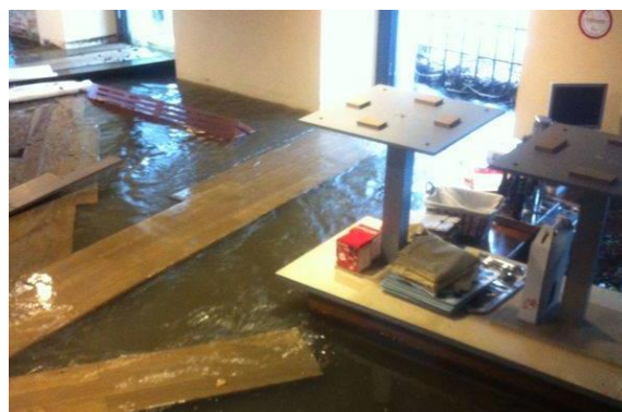
Figura 71. Efectos de la inundación en la planta baja del bar-restaurante Ingenio Chico, con tarima flotante de madera levantada y los elementos del mobiliario sumergidos. Fuente: Segovia al Día. www.segoviaaldia.es Autor: Javier López Alarma.
