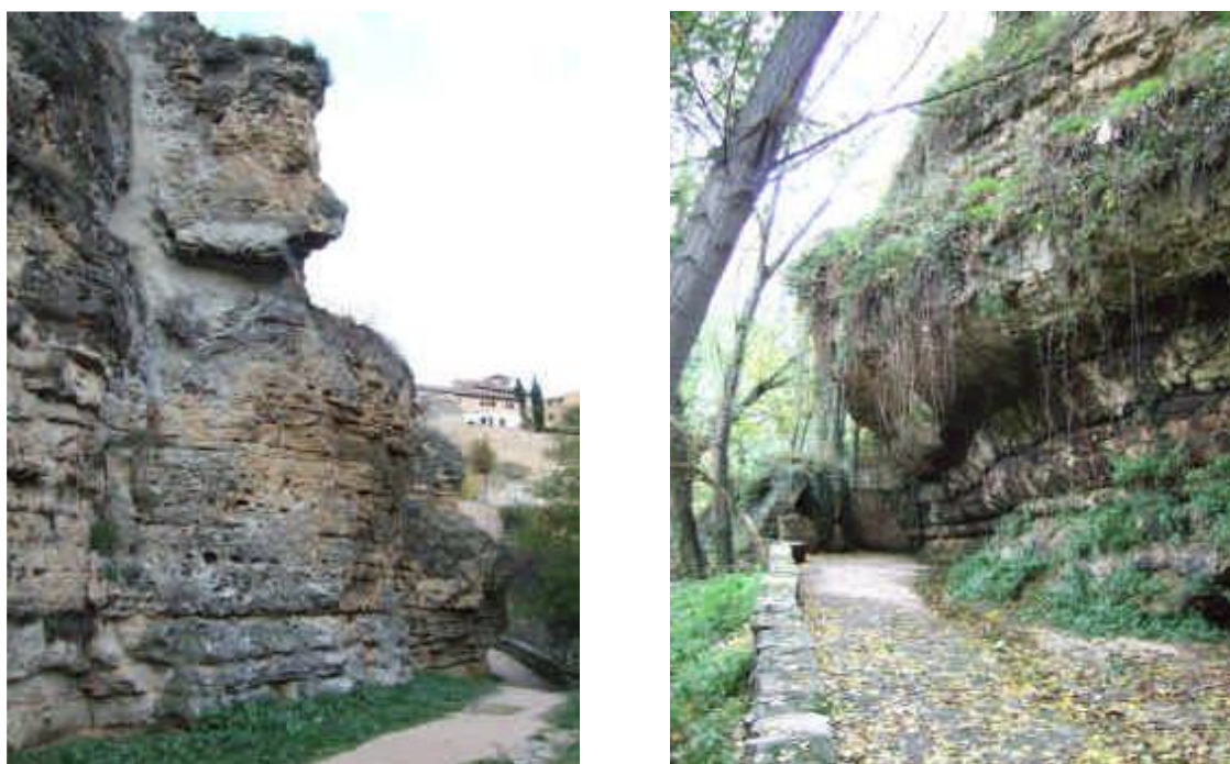
Figura 107. Cortado en roca con bloque inestable con las diaclasas selladas con gunita (izquierda) y solapo en extraplomo en un área estancial con abundantes rezumes del acuífero cárstico (derecha).
