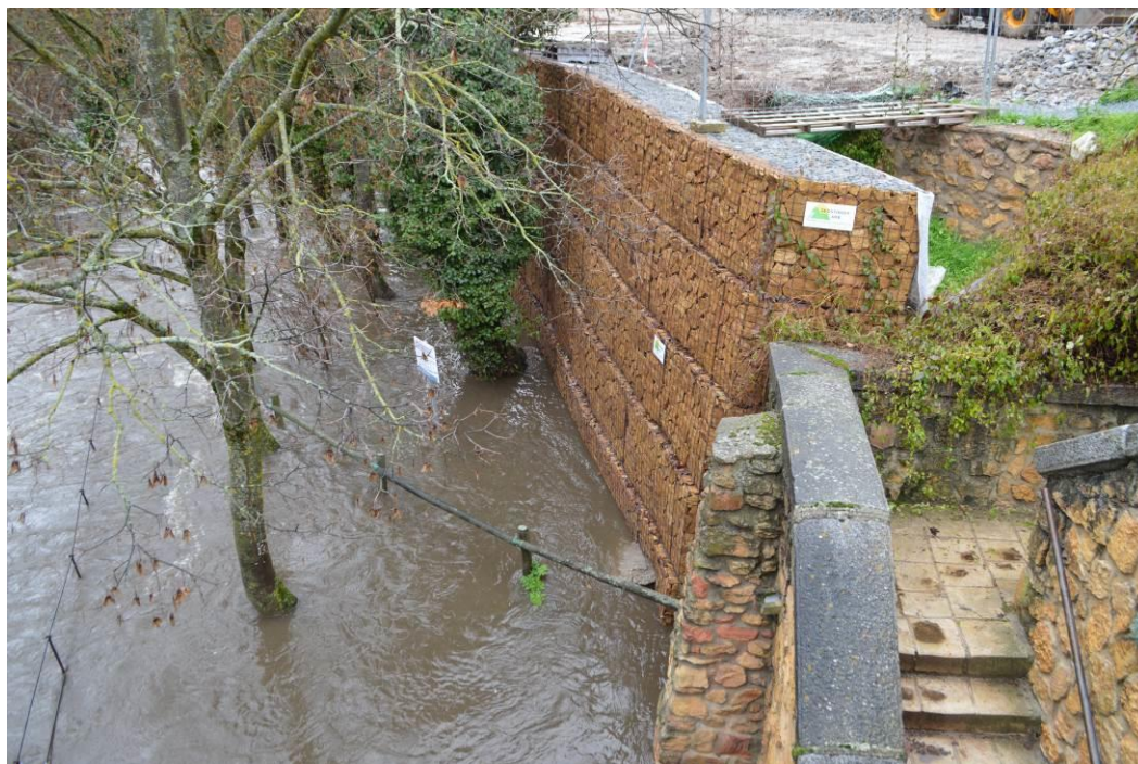
Figura 79. Inundación del paseo paralelo al río por la margen derecha aguas abajo del puente de la Casa de Moneda, hasta la base del nuevo gavión de caja instalado para la contención del talud de una finca privada; lo que luego generaría el desmoronamiento del muro del cauce y la interrupción del camino.
