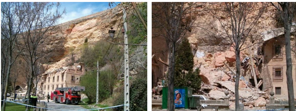
Figura 96. Desprendimiento de rocas de Peñas Grajeras (izquierda), ocurrido el 7 de abril de 2005, el cual destruyó buena parte de la Casa del Capellán aneja al Santuario de La Fuencisla (derecha).
