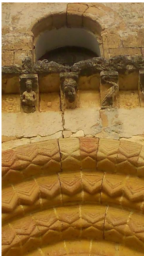
Figura 86. Fachada occidental de la iglesia de la Veracruz, con las claves ligeramente desprendidas en la ventana superior y las arquivoltas de la puerta.
