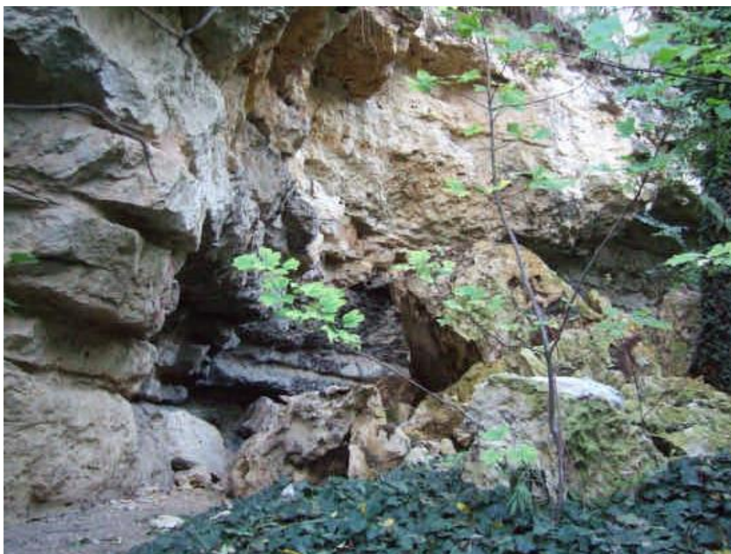
Figura 106. Cicatriz de desprendimiento y bloques desprendidos desde taludes verticalizados en la ladera izquierda de la cabecera del cañón del Clamores.
