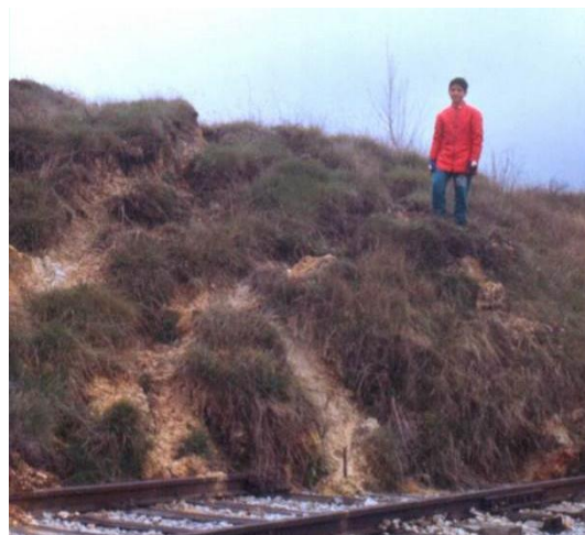
Figura 122. Pie del deslizamiento rotacional complejo en un movimiento de avance a comienzos de la década de 1980, cubriendo la vía de reserva de la estación de ferrocarril.
