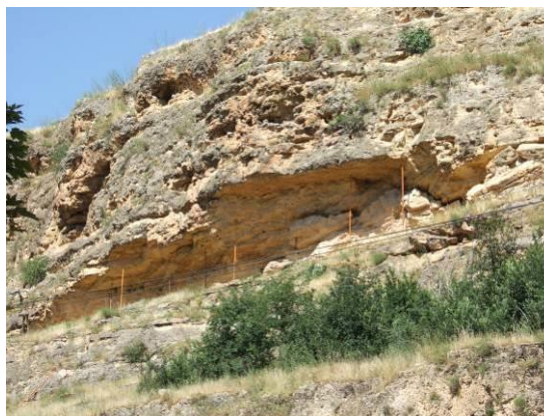
Figura 100. Zona próxima al arco de la Puente Castellana, cortada por desprendimientos en julio de 2008 (izquierda), y cornisa volada con simples puntales de sujección (arriba).
