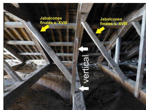
Figura 89. Inclinación respecto a la vertical de las cerchas de la cubierta de la nave central de la Catedral de Segovia, y jabalcones para apuntalar la estructura.
