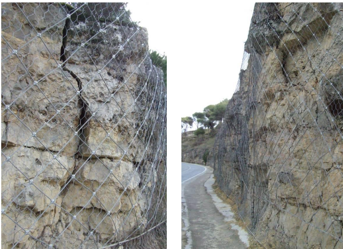
Figura 104. Sistema de estabilización y retención 'malla-talud' implantado en buena parte de la Cuesta de los Hoyos. A pesar de estas protecciones, el 22 de noviembre de 2010 se produjo un nuevo desprendimiento en uno de los taludes, suponiendo el corte del tráfico rodado e importantes costes de reparación.
