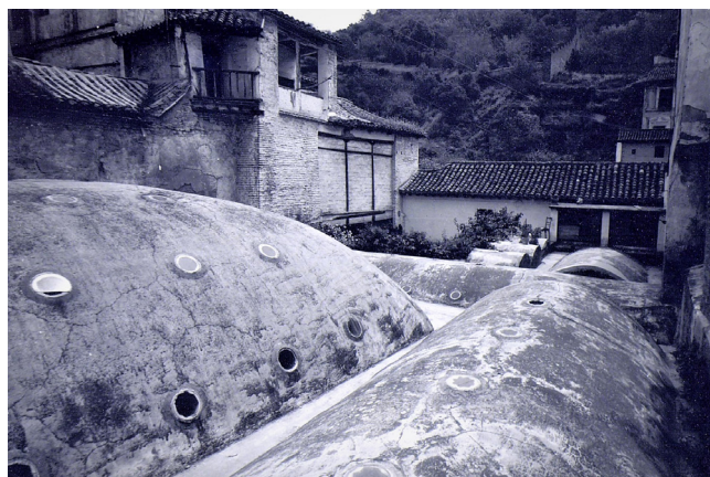
Figura 8. Bóvedas del Bañuelo antes de las obras de 1975 de Prieto-Moreno. Al fondo, volumen de la vivienda (AGA, 26/00096).
