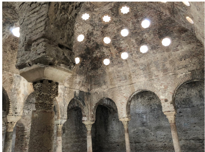
Figura 3. Intradós de la bóveda y arcos de la sala templada del Bañuelo. En primer plano detalle de columna, capitel y cimacio.
