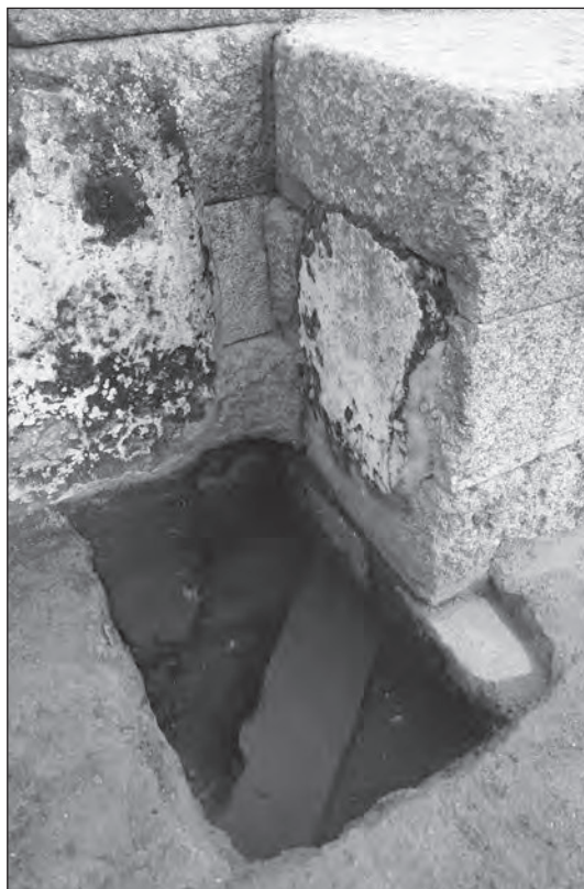
Figura 24. Detalle de amortización de estructuras anteriores a la construcción del acceso desde el pórtico exterior occidental a la versura (foto: A. Pizzo).
