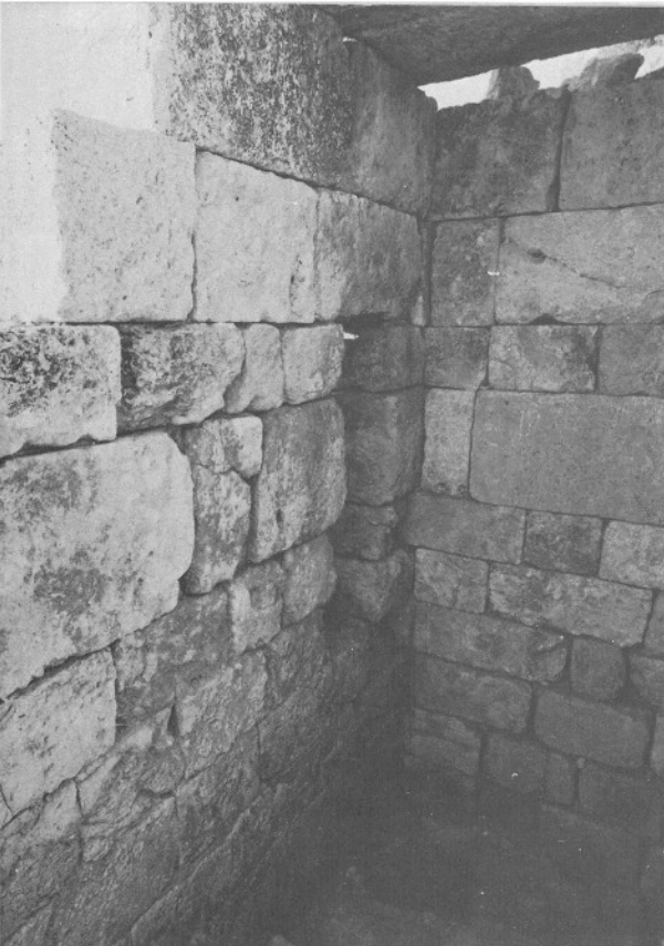
Lám. 27.c.—El cuarto tramo de la escalera después del desescombro y restauración.
