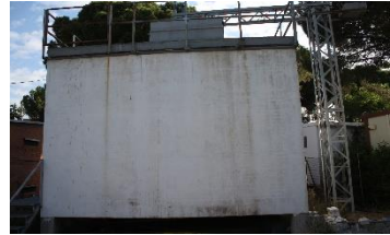
Figura 1: Aspecto inicial de la pared
