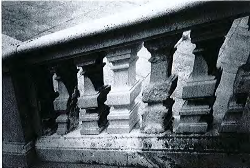
Foto 5.- Diferentes grados de alteración en los balaustres calcáreos de una escalera. 1: zona de lavado (color claro) y zona de no lavado (color oscuro). 2: sustitución completa del elemento con piedra natural. 3: disolución y pérdida de material. Palacio Real, Madrid (Foto E. Pérez Monserrat).
