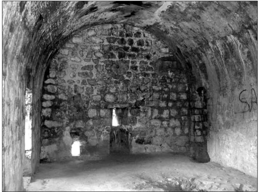
Vista del paramento norte de la sala alta del Molino del Cubo
