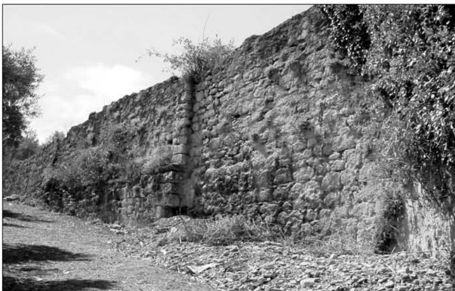
Cara externa del acueducto del Molino del Cubo en el que se aprecian las distintas reparaciones que ha tenido a lo largo de su historia
