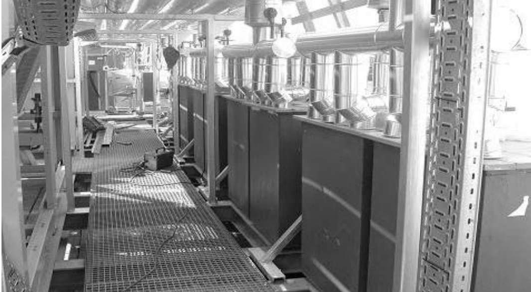
Fig. 7 Vista parcial de una de las instalaciones formada por 32 m 3 de PCM , los tanques fueron de 1 m 3 , ver (31)
