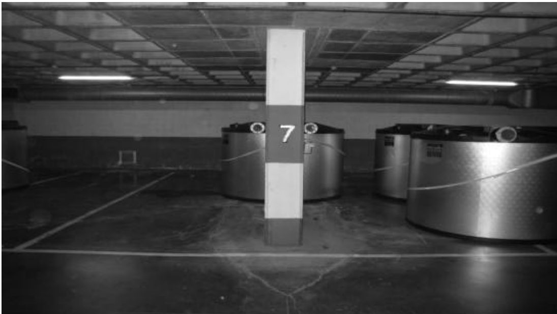
Fig. 8 Vista parcial de una instalación de 180.000 Kg. de PCM, los tanques son cilíndricos de plástico de 4 m 3
