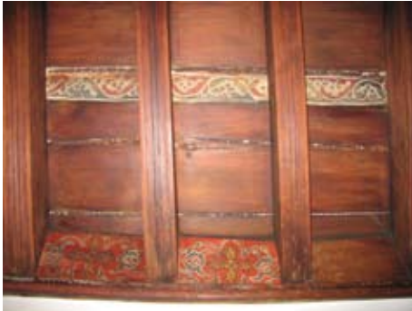
Figura 10.- Casa en el Callejón de San Luís Alto, nº 9. Restauración de pinturas en la armadura de la sala alta norte.
