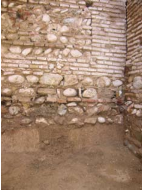
Figura 4.- Casa morisca en la Calle de San Buenaventura, nº 2. Muro norte de la sala baja norte, donde se puede apreciar la carencia de cimientos.
