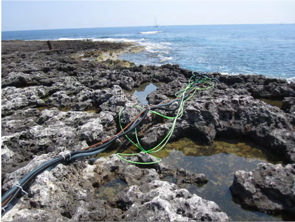
Foto 4: Cables rotos en la entrada al mar
