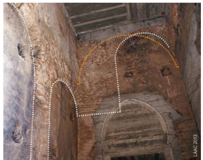
Fig. 24. Dar al-Hana. Edificio residencial. Bóvedas de la crujía de acceso (véase situación en la Fig. 22.A1). Se ha marcado con línea naranja el luneto de la bóveda longitudinal, posteriormente modificada por la secuencia de bóvedas de la segunda fase, señaladas con línea blanca
