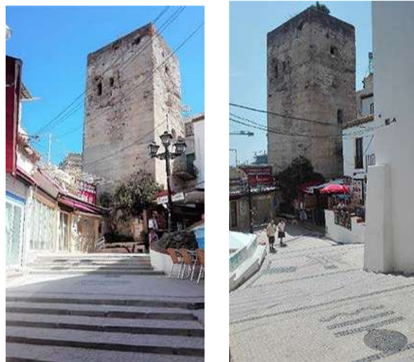
Figura 1: Estado actual de la Torre de Pimentel. Fuente: Memoria Preliminar de Análisis de estructuras emergentes del BIC Torre de Pimentel (Torremolinos)
