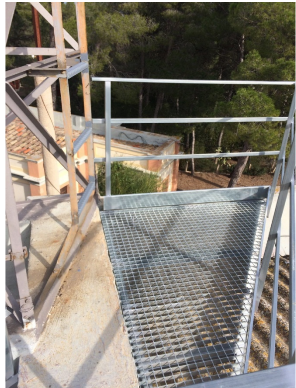
Fig. 23. Detall dels nous roda-peus, barana i elements de protecció. Detalle de los nuevos rodapiés, barandillas y elementos de protección.
