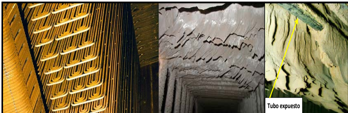
Figura 4. Comparativa del aspecto de los tubos recuperadores, antes y después del servicio.
